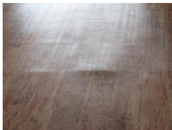
Pløser og buler på gulvbelegg
