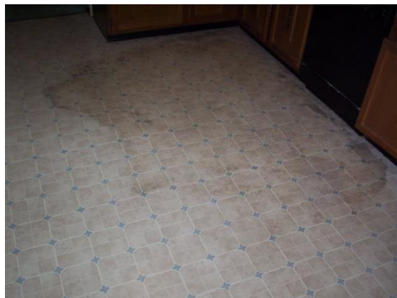
Misfarging på gulvbelegg
